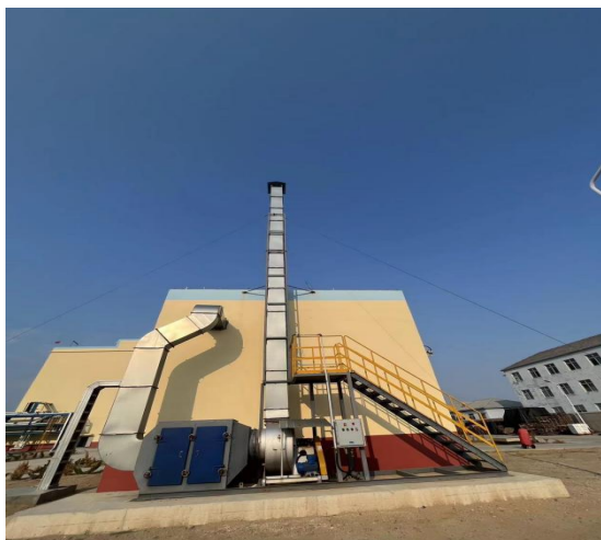
废气治理设施
