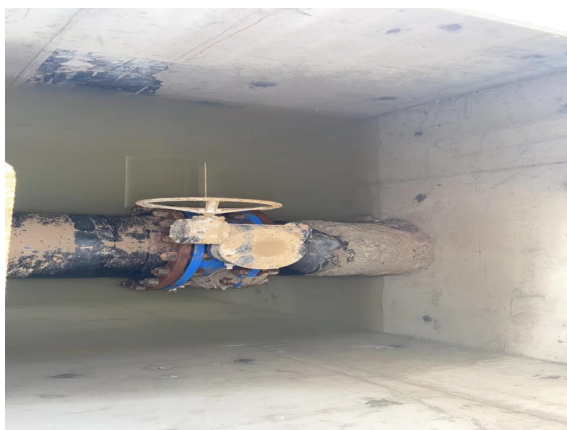
应急切换装置
